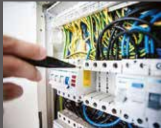
Elektra, beveiliging- & ontruimingsinstallatie
